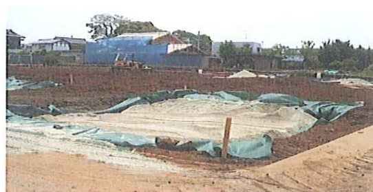
宅地開発地内の雨水貯留浸透層
